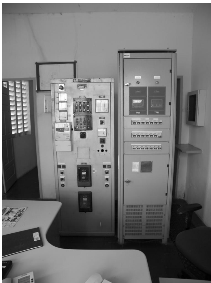
Figura 32: Antigos Painéis de Controle da Subestação
